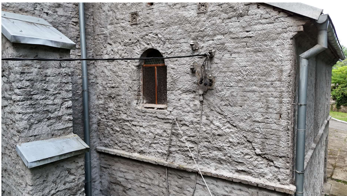
Fot. 22 Widok na przypory i aneks dwukondygnacyjny od strony północnej. Widoczne elementy instalacji elektrycznej szpecącej elewację, zły stan obróbek blacharskich, brak parapetów przy oknach, elementy dekoracyjne i ornamenty wymagające odczyszczenia
