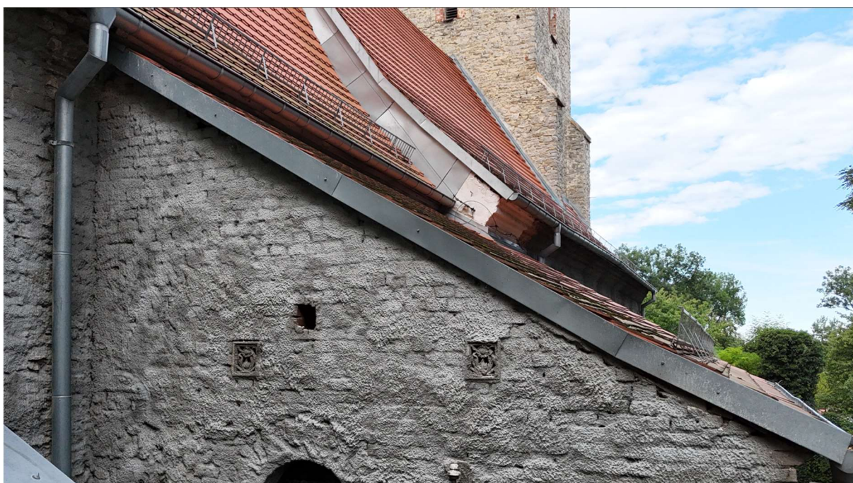
Fot. 23 Widok aneksu dwukondygnacyjny od strony północnej. Widoczny jedyny zachowany fragment gzymsu.
