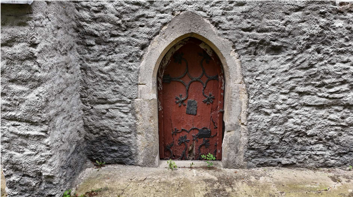
Fot. 27 Widok od strony południowej- stolarka drzwiowa wymagająca renowacji.
