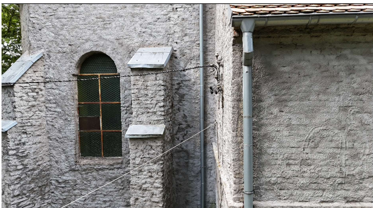
Fot. 21 Widok na przypory i aneks dwukondygnacyjny od strony północnej. Widoczne elementy instalacji elektrycznej szpecącej elewację, zły stan obróbek blacharskich, brak parapetów przy oknach, elementy dekoracyjne i ornamenty wymagające odczyszczenia
