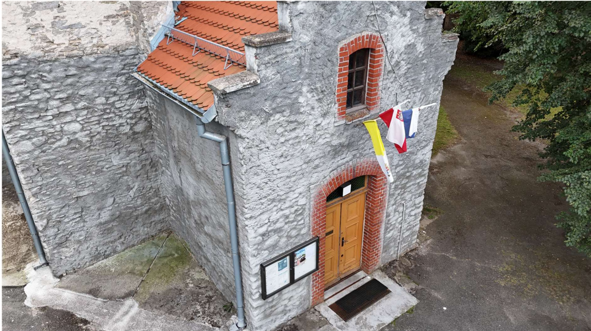
Fot. 18 Widok na kruchnę od strony zachodniej- główne wejście do kościoła. Widoczne elementy szpecące: kabel zasilający oprawę oświetleniową, gabłota ogłoszeniowa o zbyt dużej szerokości- nachodząca na opaskę drzwiową z cegły klinkierowej, brak parapetu przy oknie na piętrze kruchny, część dachówek wymagająca przełożenia.
