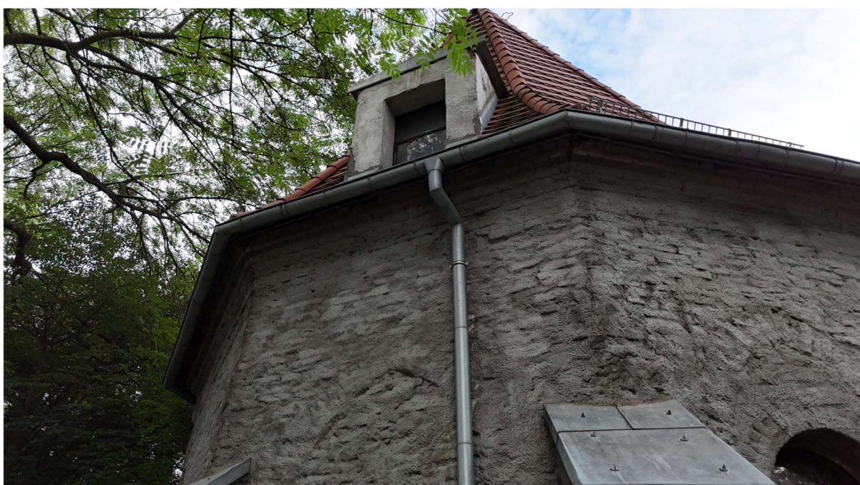
Fot. 25 Widok od strony wschodniej- nieotynkowana lukarna w dachu. Okno lukarny w złym stanie technicznym.
