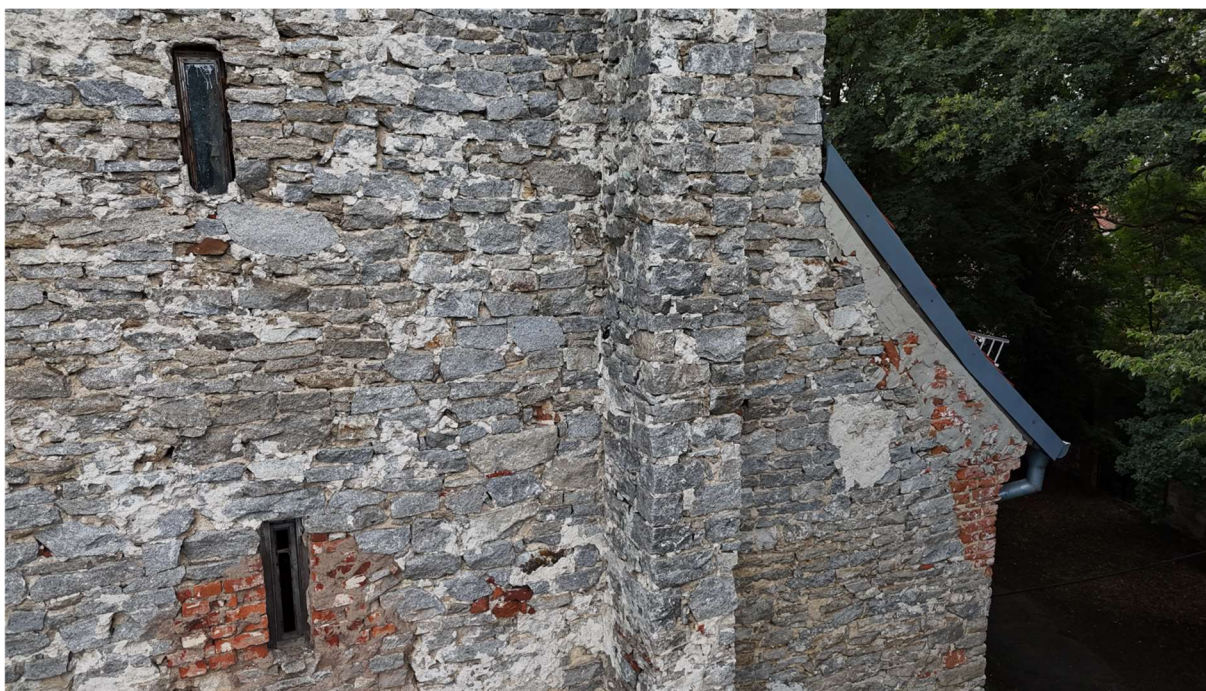
Fot. 20 Widoczna struktura ściany z granitu i cegły, zły stan stolarki okiennej, brak obróbek otworów okiennych, opasek i parapetów.
